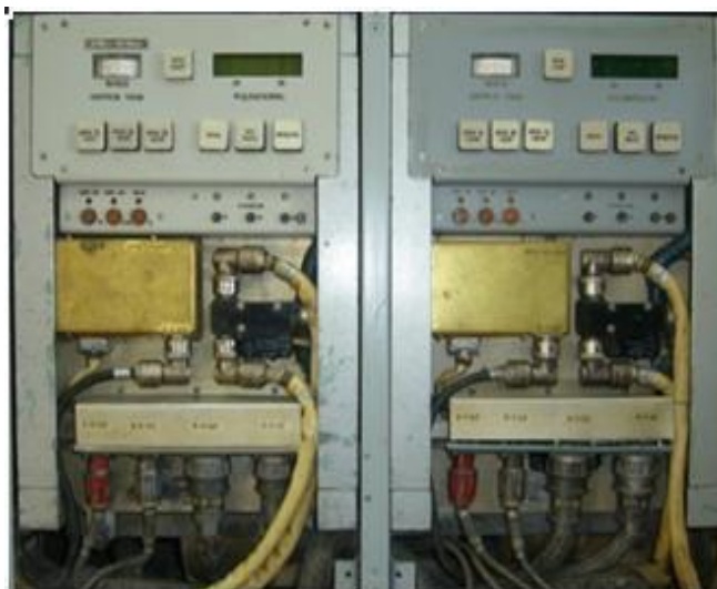
2.2- rasm. Quvvat kuchaytirgich (QT va UQT) blokining old tomondan umumiy ko‘rinishi.
