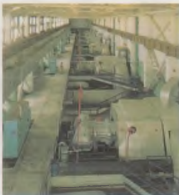
Хива газ компрессор станцияси.
