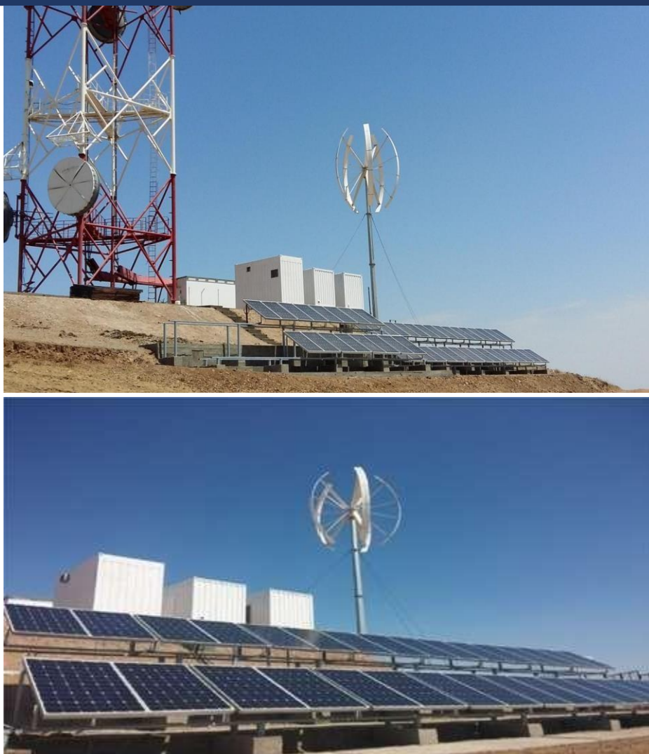
Рис. 5, 6. Автономный гибридный солнечно-ветро-дизельная электростанция на 10 кВт на объекте «Замбар»
